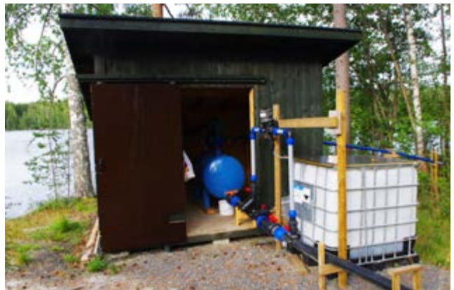
↑ Pumppuaseman rakennus suojaa sähkömoottorin ja hiekkasuodattimen sekä vaimentaa pumpun melua. Kuution konttiin tehdään emoliuos tihkulannoitusta varten.
