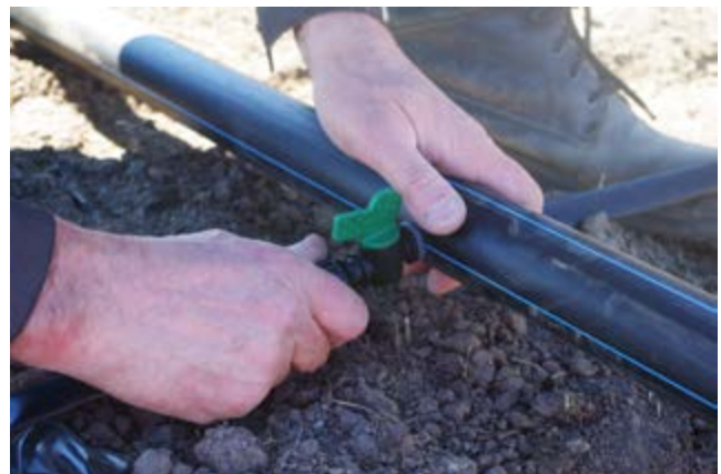
↑ Tihkuletku liitetään jakoputkeen.
